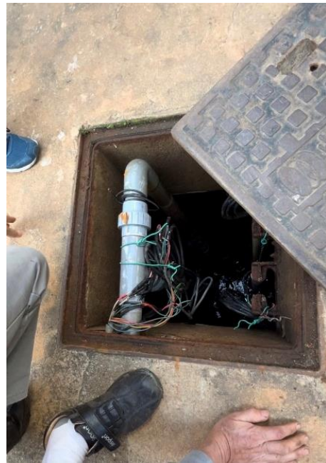
一台泵浦入水位置
