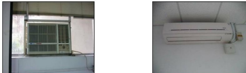
圖 5、汰換老舊高耗能窗型冷氣為分離式冷氣，並導入能資源智慧管理系統，搭配課表控制、卸載管控及停機排程功能
