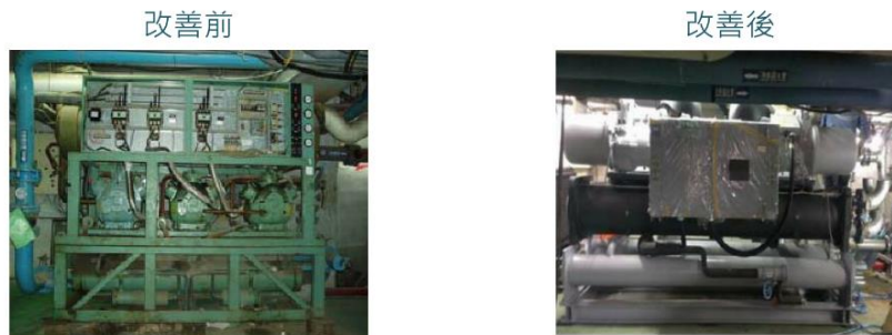
圖 4、老舊往復式冰水主機汰換為螺旋式冰水主機加裝變頻器泵浦
