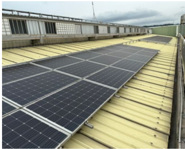
圖 1 屋頂型太陽光電設施例
